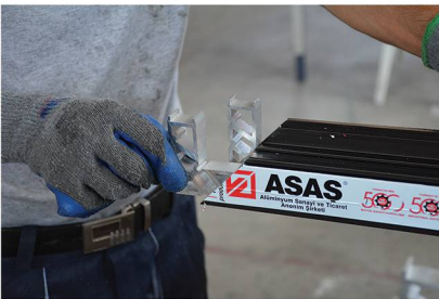
کنترل مطابقت فیکسرها و پروفیل
